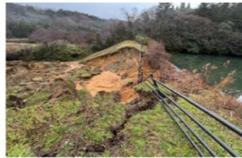
ため池の被害
