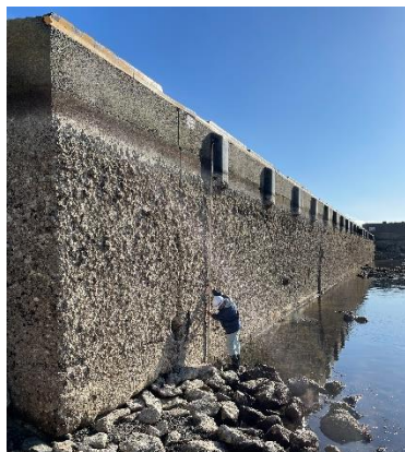
地盤隆起した鹿磯漁港
