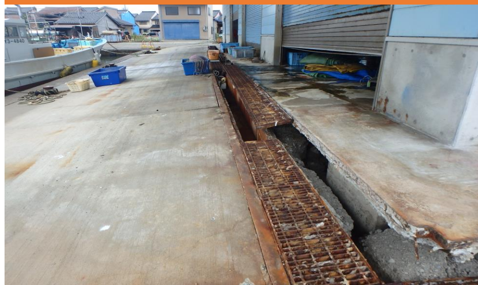
令和6年能登半島地震（富山県） 地震により段差が発生 埋設配管破損等の被害
