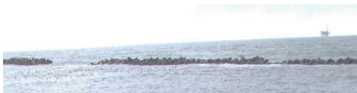
離岸堤の老朽化が進行している事例
