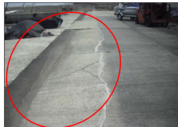
エプロン部の沈下、ひび割れ
