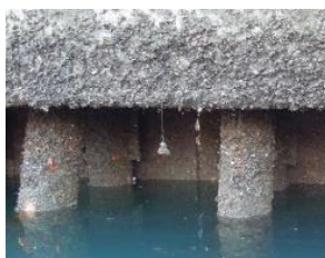
老朽化した岸壁
