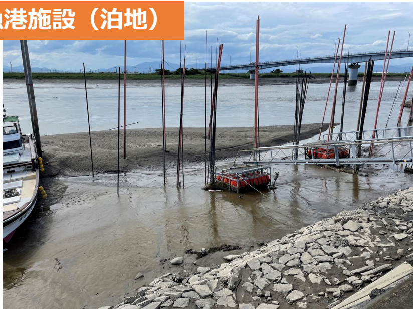
令和5年6月豪雨（佐賀県） 泊地の土砂埋そくにより漁船の航行に支障
