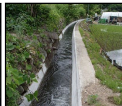
老朽化した用水路の整備・更新
