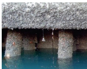
老朽化した岸壁
