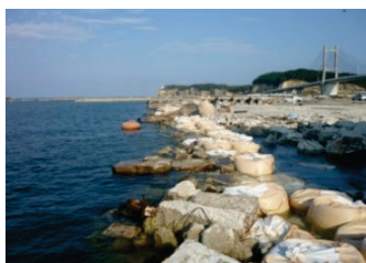
地震により岸壁が倒壊
