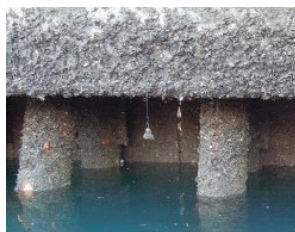
老朽化した岸壁
