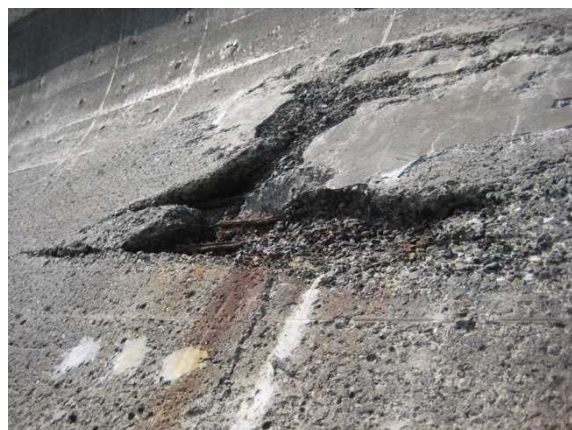
堤防の老朽化
